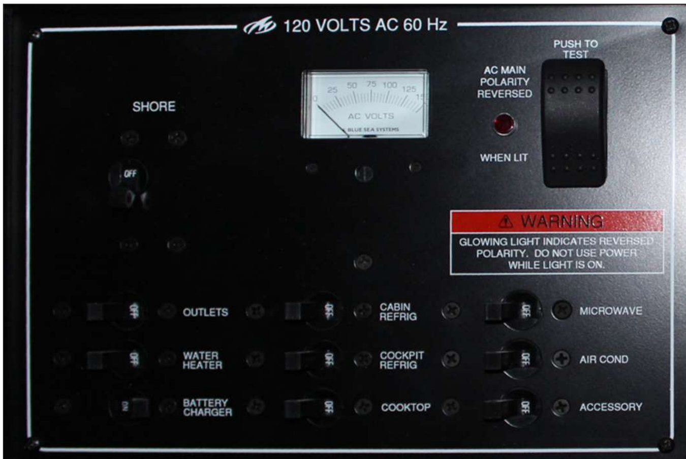
328SS 120 Volt AC Panel
